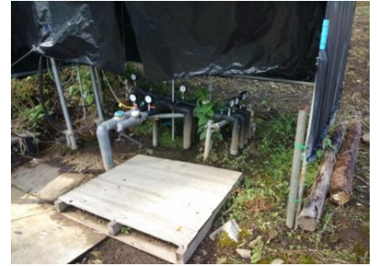
地下水くみ上げポンプ小屋
