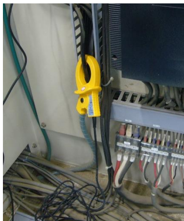
図 2 計測器設置の例
