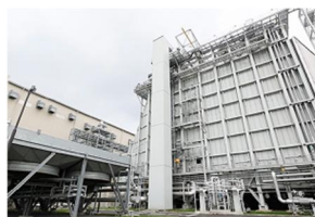
排熱回収ボイラー
