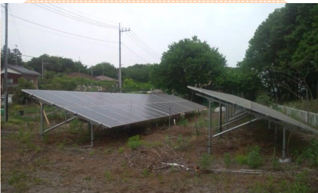
太陽光パネル
