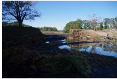
決壊した向溜の堤体の様子
